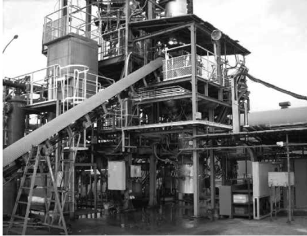
Figura 2. Unidade piloto de gaseificação/fusão para produzir o combustível gasoso a partir de resíduos.
